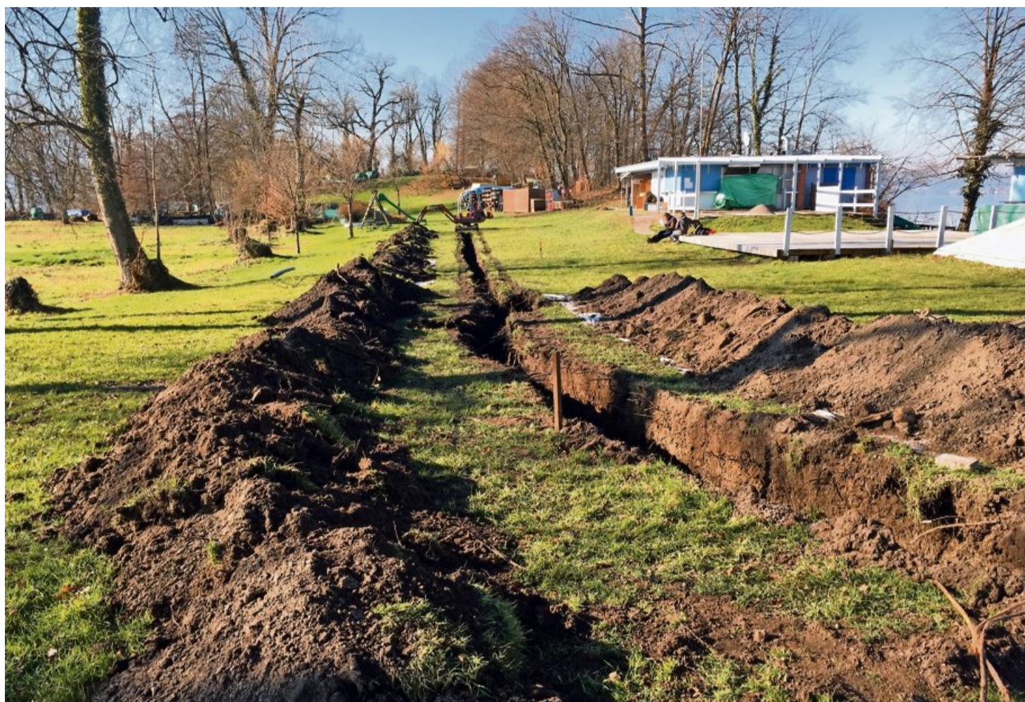
Die Grabungen auf der Lützelau sind bereits fortgeschritten: Hier werden später die Anschlüsse der Werkleitungen fertiggestellt. Fotos: Ortsgemeinde Rapperswil-Jona
